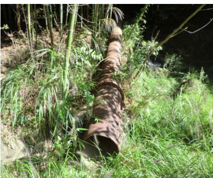
発電所跡地に残された水圧管
